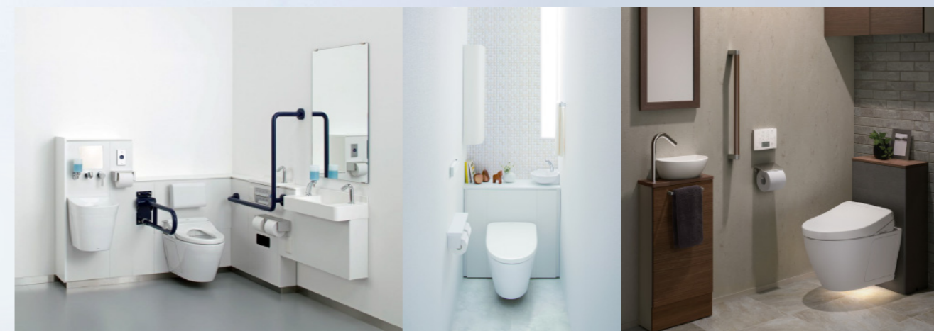
Nhà vệ sinh công cộng và nhà vệ sinh tại hộ gia đình sử dụng WASHLET ở Nhật Bản.
